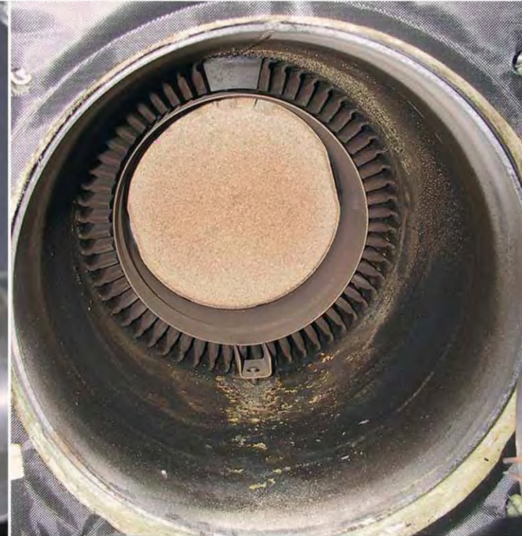
Ölheizkessel nach 1.800 Betriebsstunden
