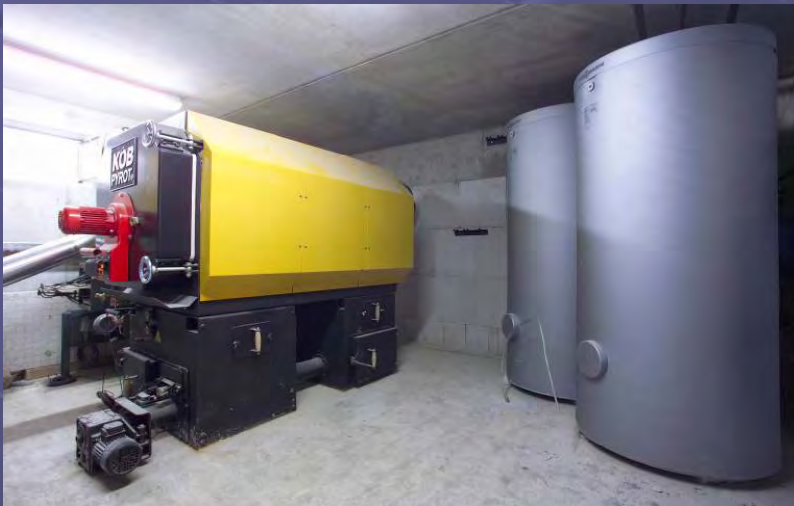
Holzessel mit Pufferspeicher
